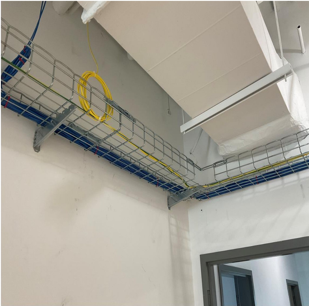
AV & Data Wire @ Cable Trays
